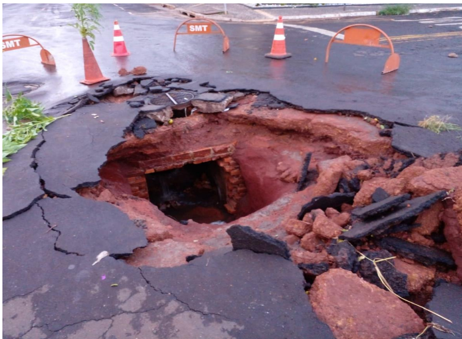
Figura 24 - Galeria pluvial danificada por fortes chuvas.
