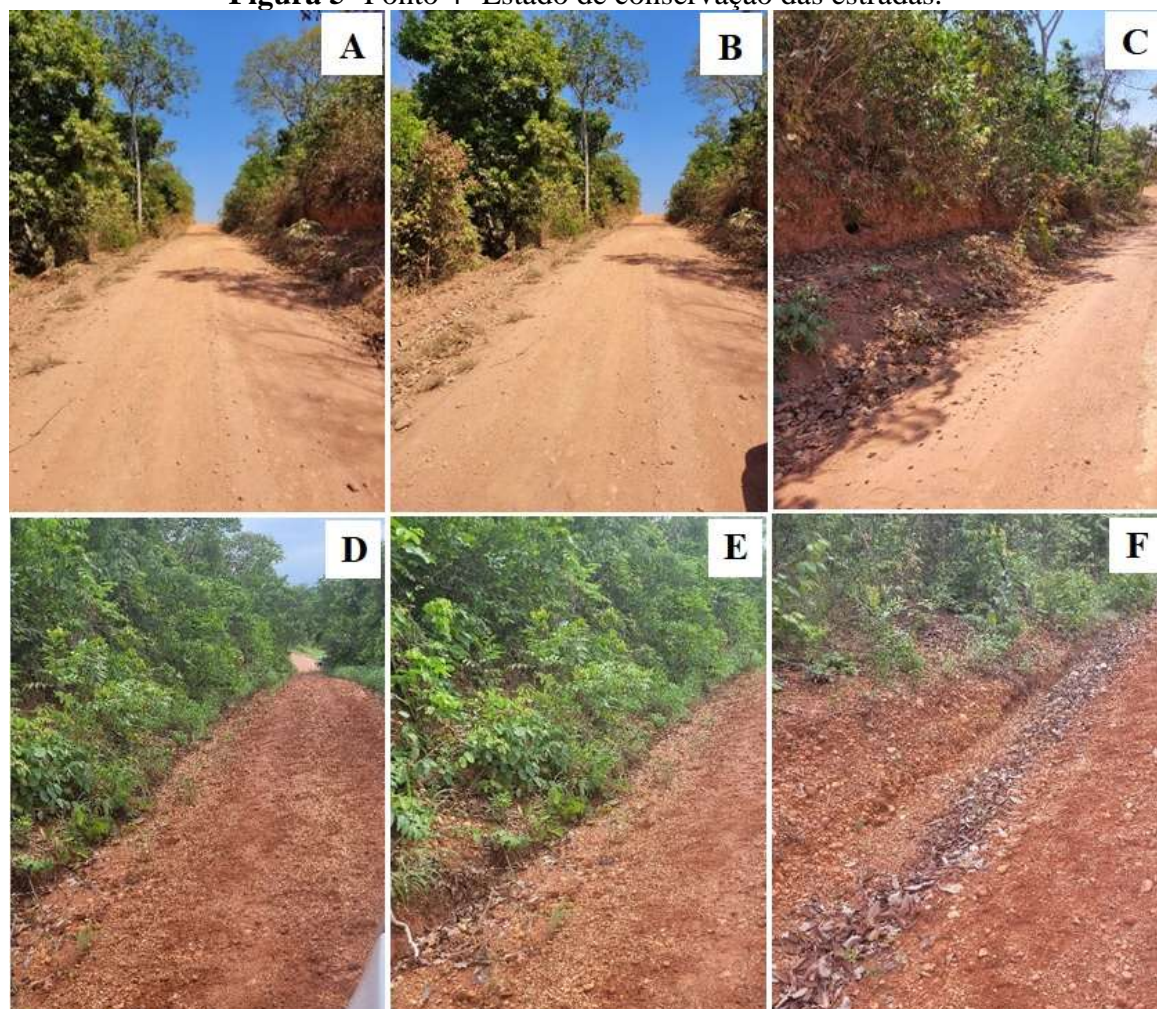
Figura 5- Ponto 4- Estado de conservação das estradas.
