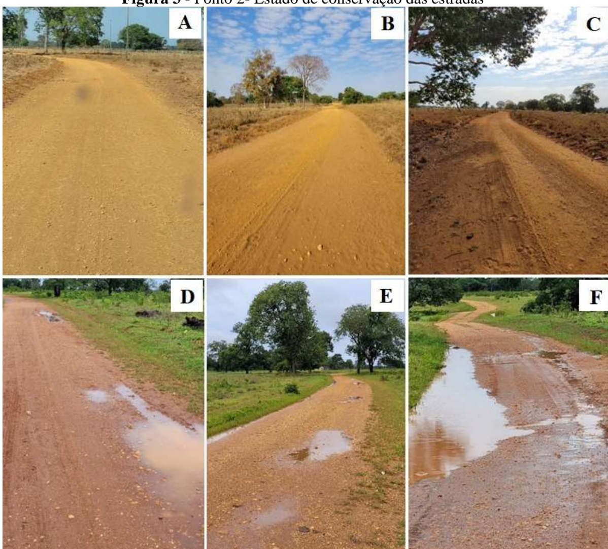
Figura 3 - Ponto 2- Estado de conservação das estradas
