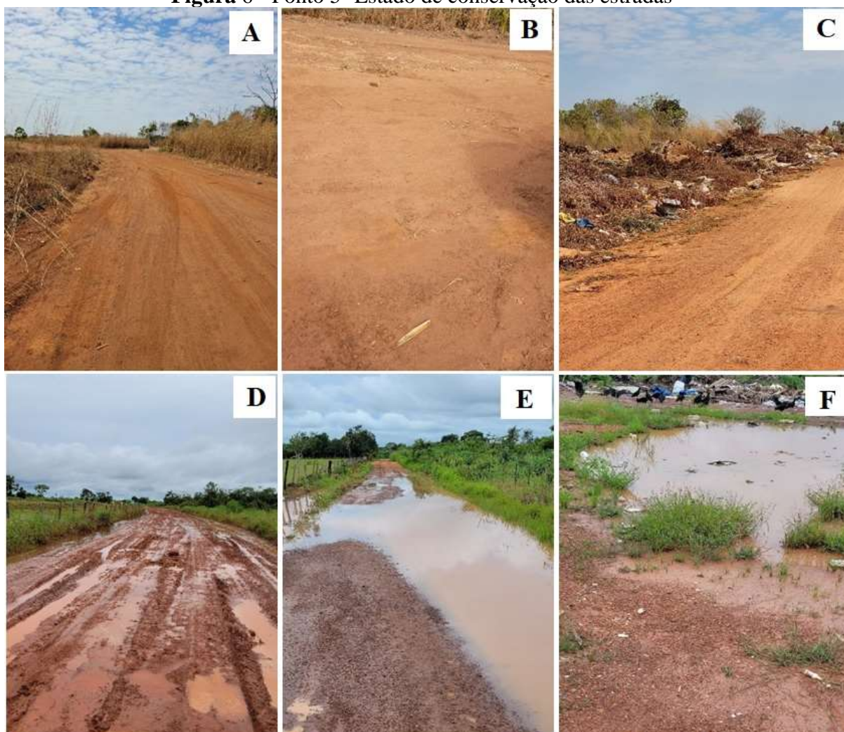
Figura 6 - Ponto 5- Estado de conservação das estradas
