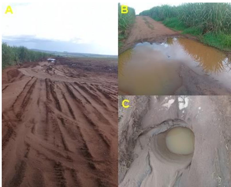
Figura 13- Estado de conservação das estradas do ponto 3. Campo do dia 20/12/2019:
