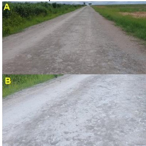
Figura 7- Estado de conservação das estradas do ponto 2. Campo do dia 20/12/2019:
