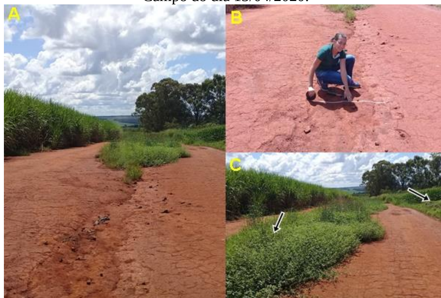
Figura 3- Estado de conservação das estradas do ponto 1. Campo do dia 13/04/2020:
