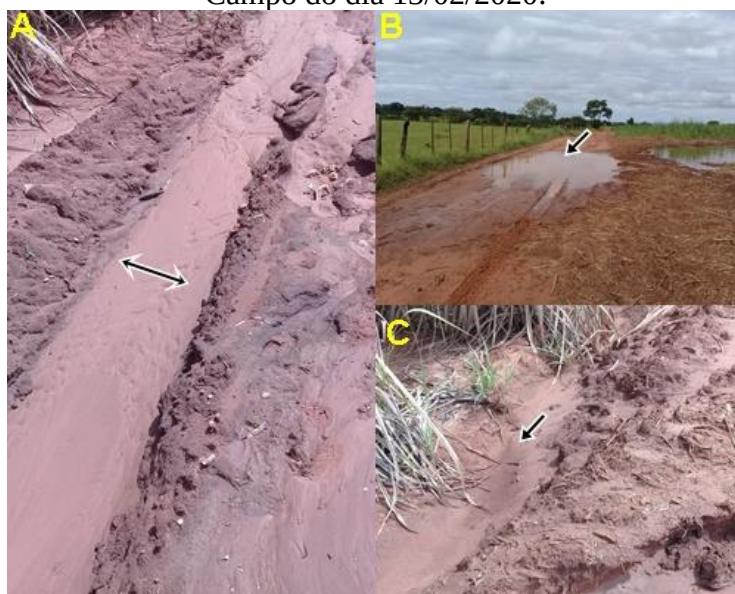
Figura 14- Estado de conservação das estradas do ponto 3. Campo do dia 13/02/2020:
