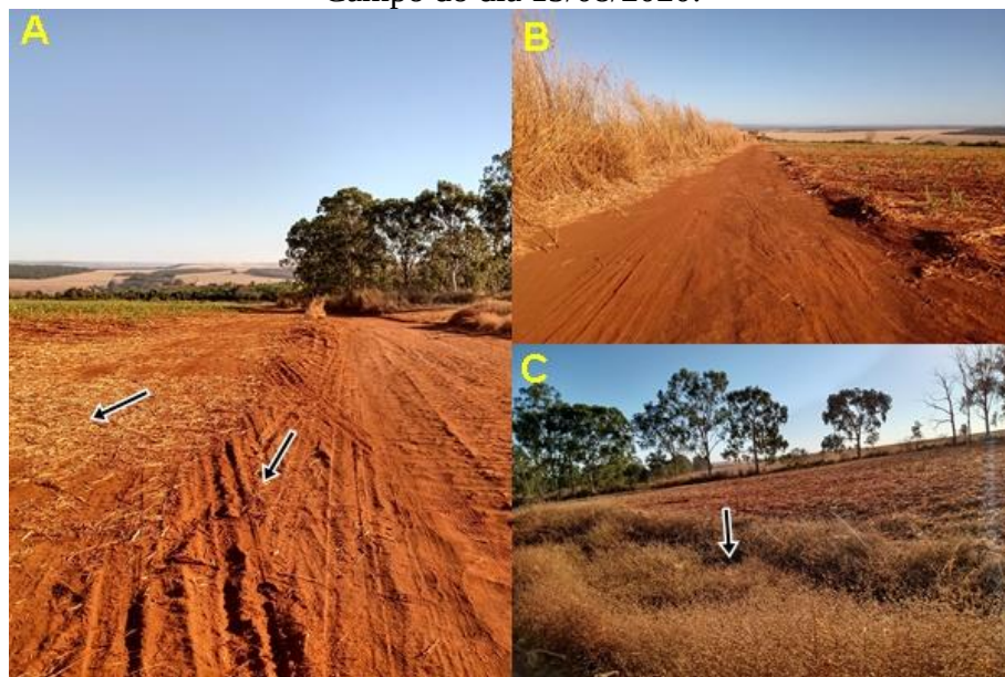
Figura 5- Estado de conservação das estradas do ponto 1. Campo do dia 15/08/2020:
