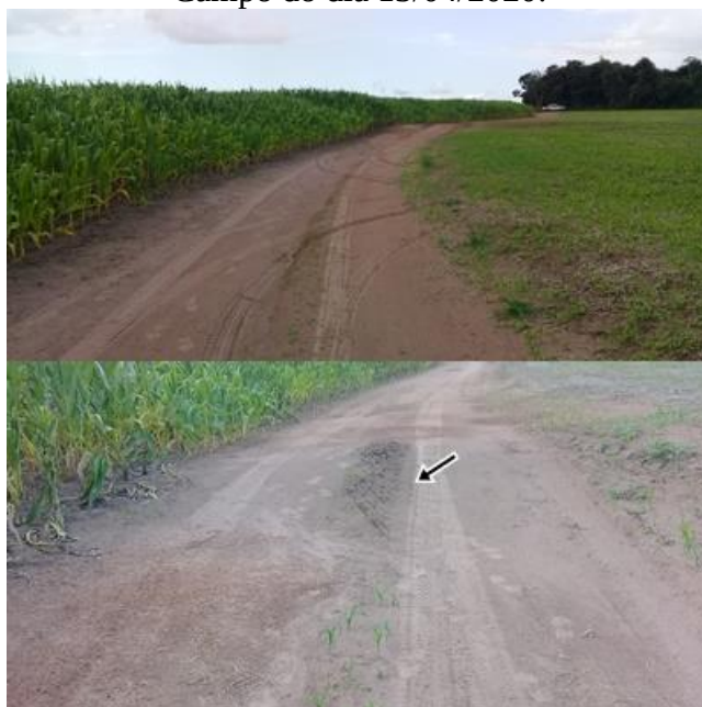
Figura 27- Estado de conservação das estradas do ponto 5. Campo do dia 13/04/2020:
