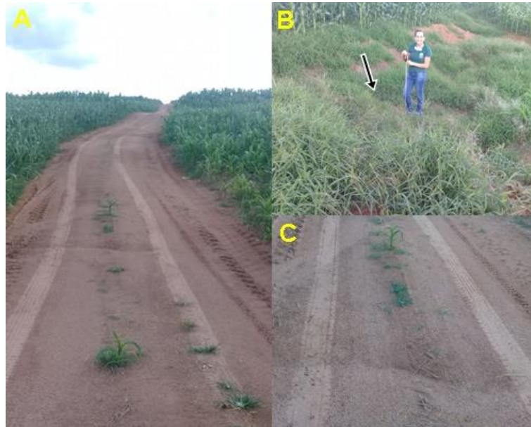
Figura 21- Estado de conservação das estradas do ponto 4. Campo do dia 13/04/2020
