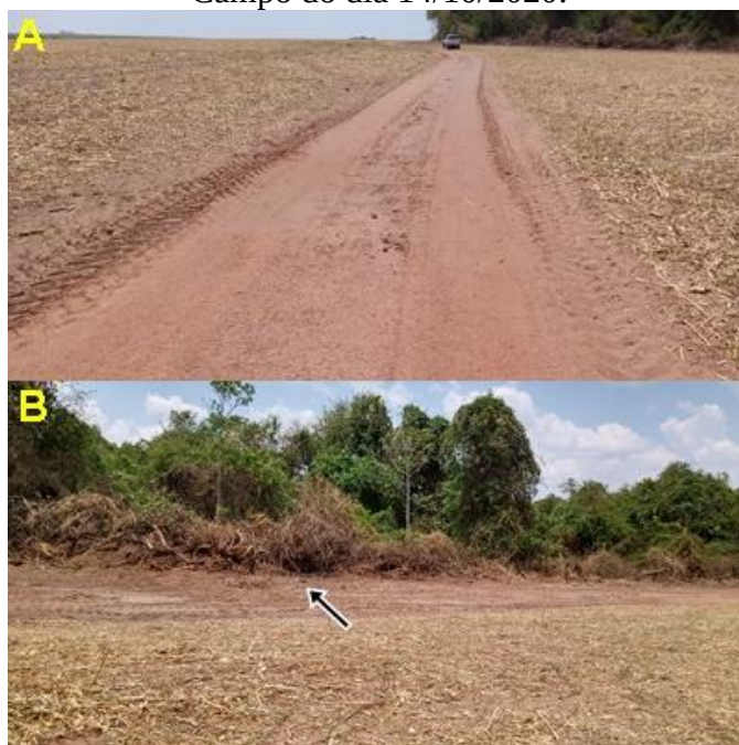
Figura 30- Estado de conservação das estradas do ponto 5. Campo do dia 14/10/2020:
