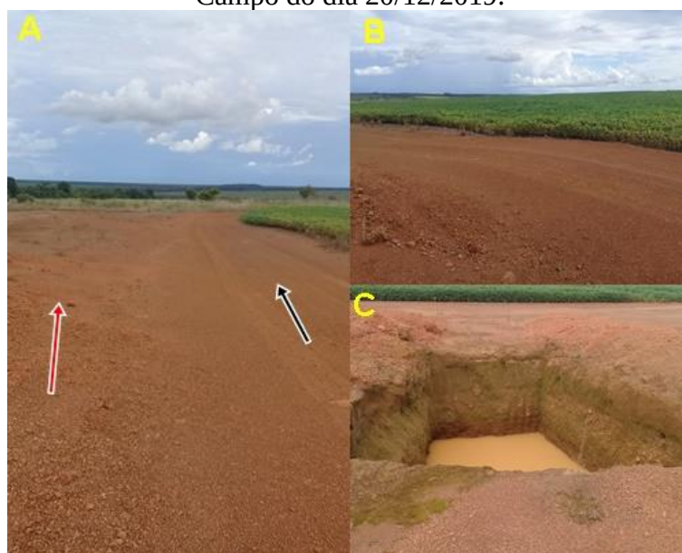
Figura 31- Estado de conservação das estradas do ponto 6. Campo do dia 20/12/2019:
