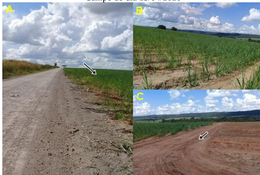
Figura 9- Estado de conservação das estradas do ponto 2. Campo do dia 13/04/2020
