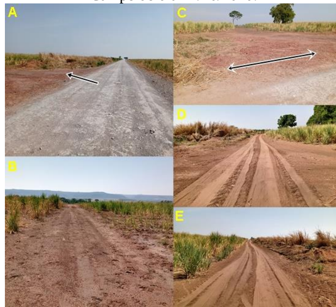
Figura 12- Estado de conservação das estradas do ponto 2. Campo do dia 14/10/2020:
