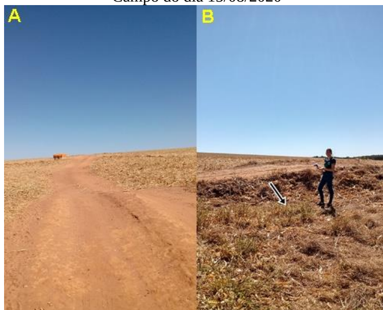
Figura 23- Estado de conservação das estradas do ponto 4. Campo do dia 15/08/2020
