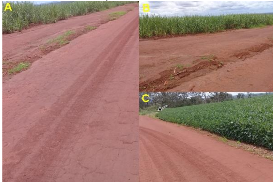
Figura 1- Estado de conservação das estradas do ponto 1. Campo do dia 20/12/2019:
