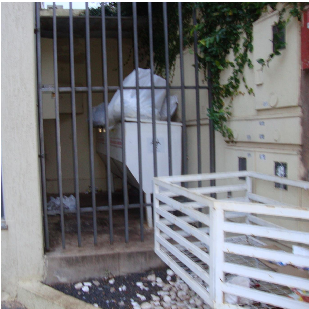
Figura 43: Resíduos de serviços de Saúde disposto em cima da caixa coletora.
