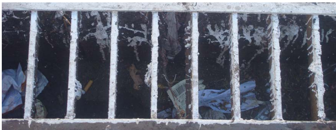
Foto 53 – Grelha em desacordo com a NBR 9050
